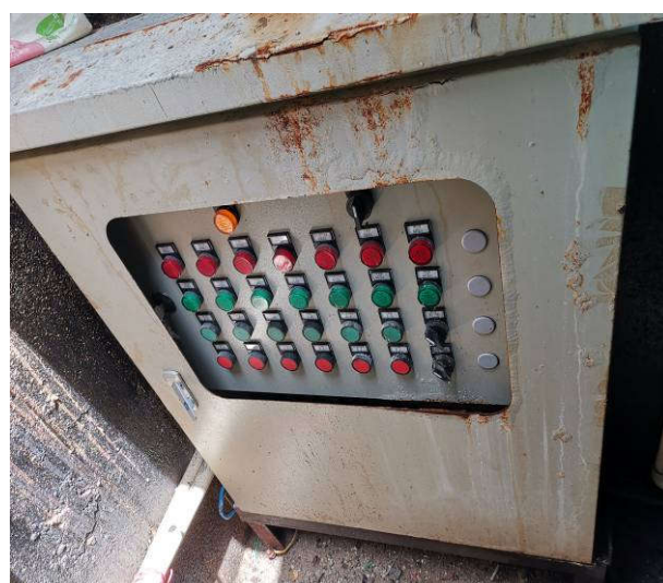
污水处理站设备开关
